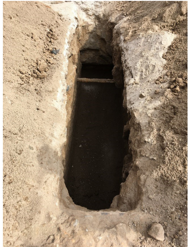
Figura 8. Inicio de los trabajos de retiro de rellenos de arena en las trincheras identificadas como cortes en la parte central de los arcos. La presencia de estas ranuras facilitó la exploración de la parte subterránea del puente. Fotografía: Ignacio Gómez Arriola, 2016.
