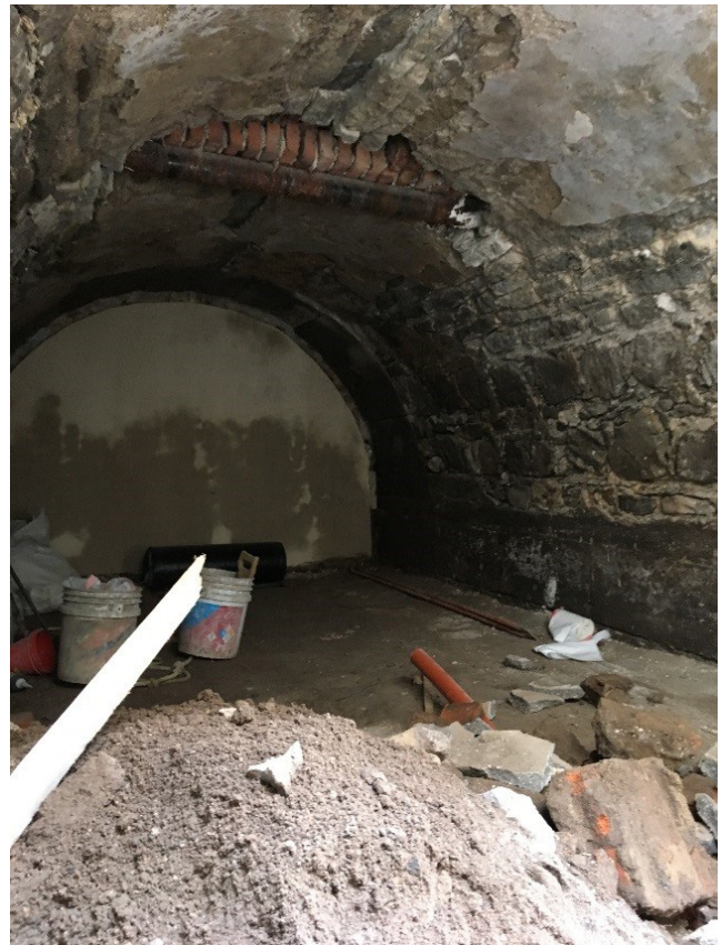
Figura 10. Como parte de los trabajos de documentación se pudieron identificar tres líneas de infraestructura que afectaron al puente, una de drenaje inferior, otra de conducción de agua y la tercera, para distribución de agua local. Fotografía: Ignacio Gómez Arriola, 2017.
