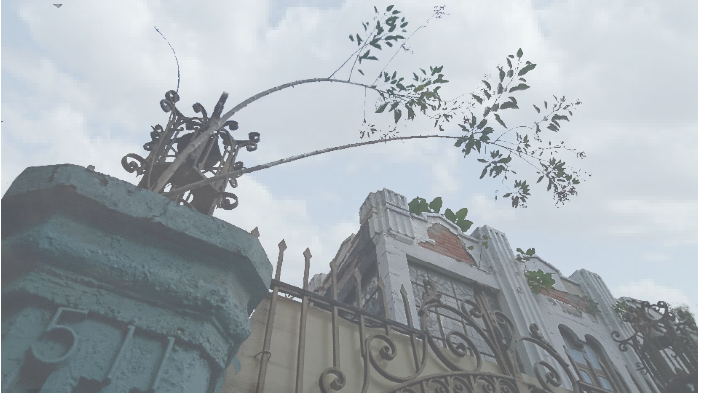
Imagen 1 Perspectiva del estado de conservación de una casa histórica. Avenida de los Insurgentes 511, Deleg. Cuauhtémoc, Col. Hipódromo Condesa, CDMX. Archivo fotográfico personal del autor. 2017.
